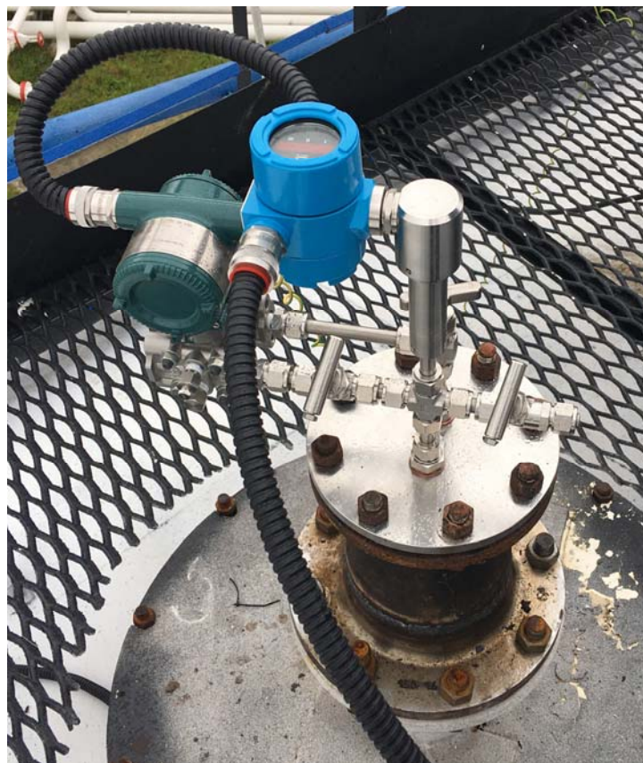
Рисунок 16 – Размещение уровнемера ВЕКТОР-ДПТ (плотномера) на резервуаре
