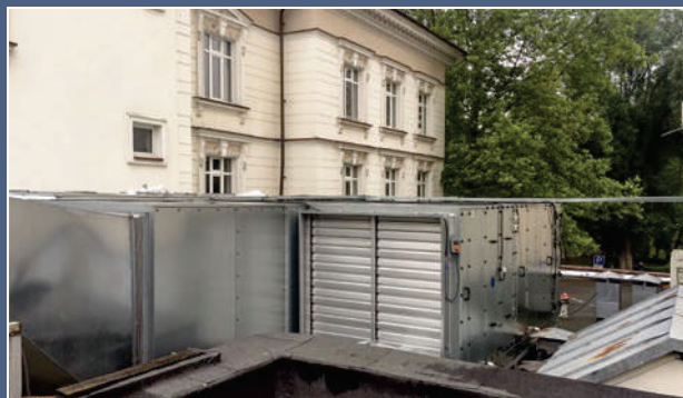
Областная Больница, г. Гродно Республика Беларусь - установка с тепловым насосом расход воздуха 31 000 м³/ч
