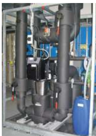
Насосная станция, фирма „Cilag AG”
