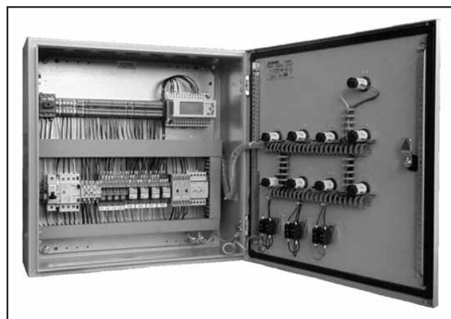
Рис. 1. Внешний вид шкафа CAУ
