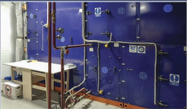
Склад «MARAT» Казахстан – установка с пластинчатым рекуператором
